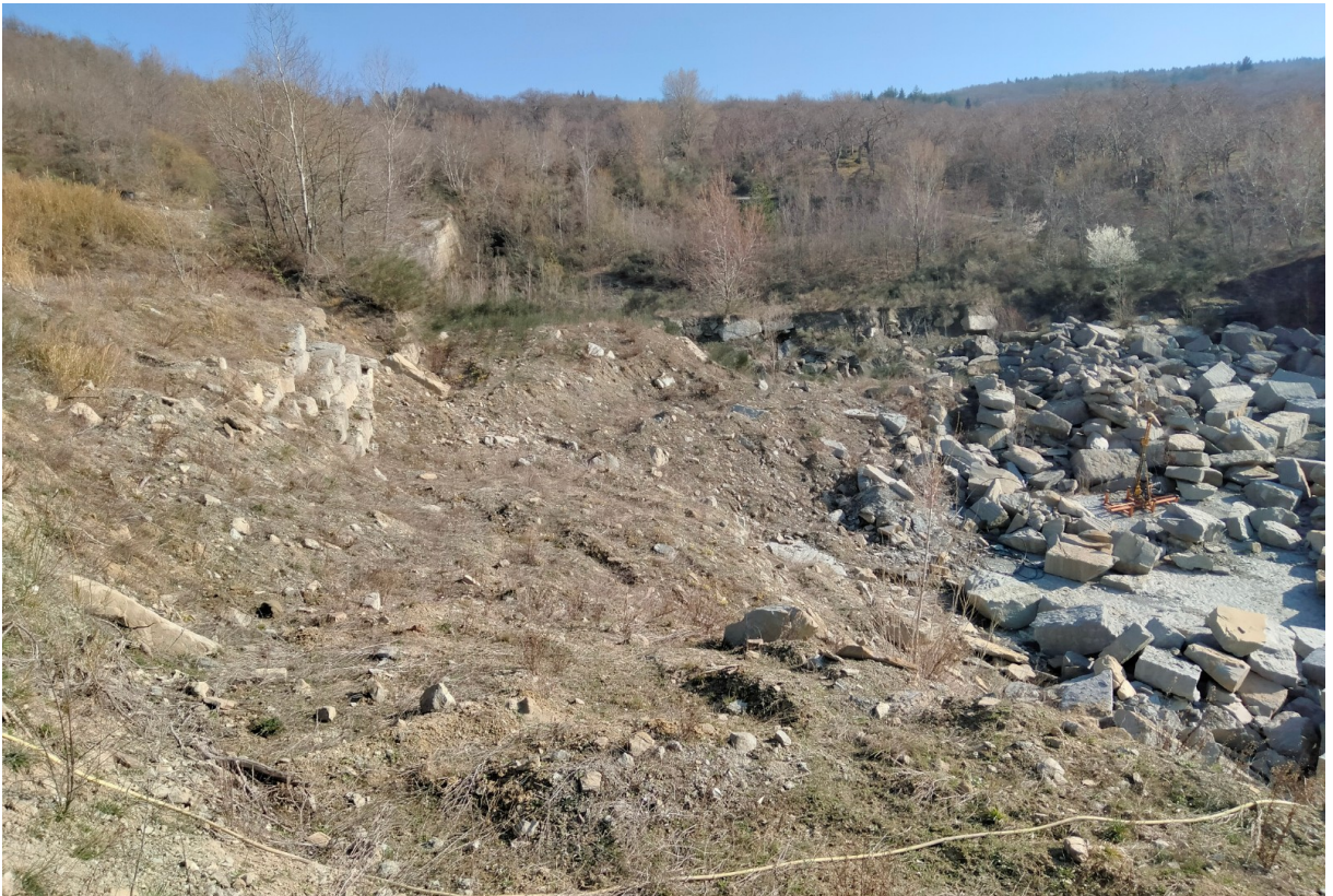
Foto 6 – La foto mostra la porzione di cava posta al margine sud, zona ormai esaurita e dove è in corso la fase di riempimento e copertura del piazzale e dei fronti di scavo. Sulla sinistra il terreno già in parte sistemato a copertura del fronte, sulla destra il materiale detritico di riempimento (i blocchi informi più grandi saranno commercializzati mentre il materiale più fine costituirà il riempimento).
