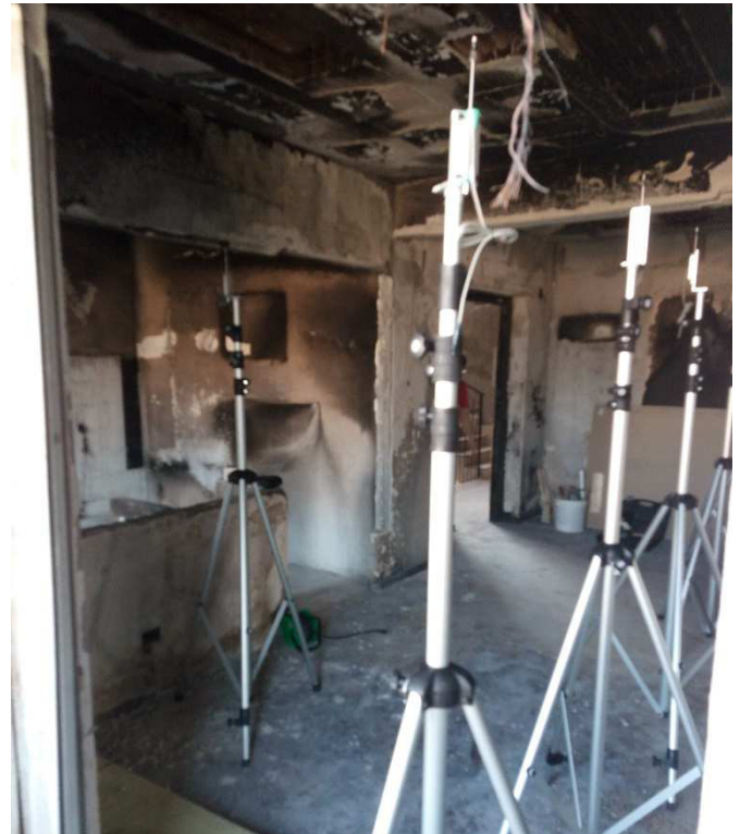
Figura 57. Immagine delle prove di carico condotte su solaio danneggiato da carico incendio
